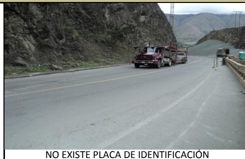
NO EXISTE PLACA DE IDENTIFICACIÓN
