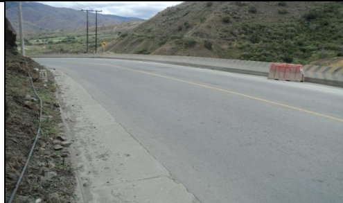
NO EXISTE PLACA DE IDENTIFICACIÓN
