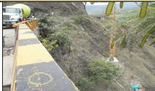
NO EXISTE PLACA DE IDENTIFICACIÓN
