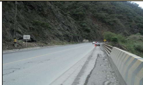
NO EXISTE PLACA DE IDENTIFICACIÓN
