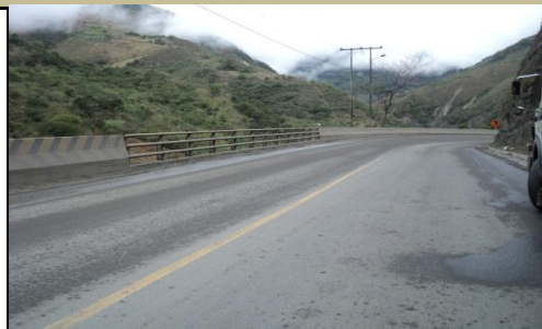
NO EXISTE PLACA DE IDENTIFICACIÓN
