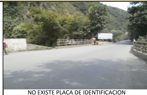
NO EXISTE PLACA DE IDENTIFICACION
