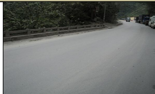
NO EXISTE PLACA DE IDENTIFICACIÓN.
