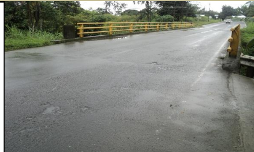
NO EXISTE PLACA DE IDENTIFICACIÓN
