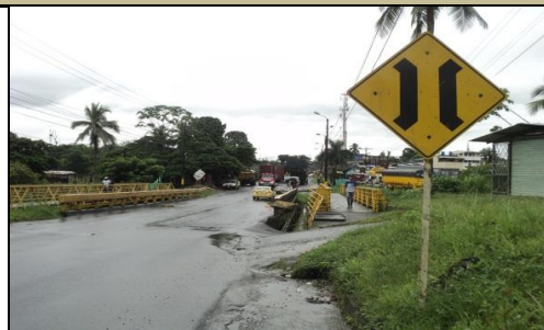
NO EXISTE PLACA DE IDENTIFICACIÓN
