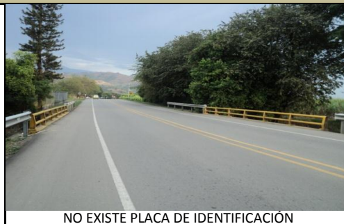
NO EXISTE PLACA DE IDENTIFICACIÓN
