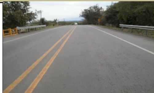
NO EXISTE PLACA DE IDENTIFICACIÓN
