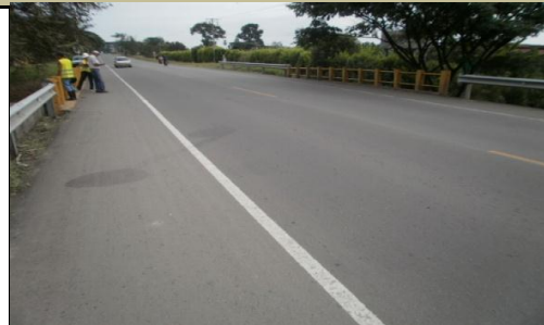
NO EXISTE PLACA DE IDENTIFICACIÓN
