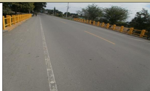
NO EXISTE PLACA DE IDENTIFICACIÓN
