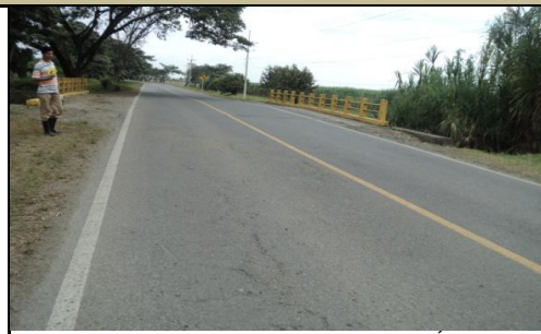
NO EXISTE PLACA DE IDENTIFICACIÓN
