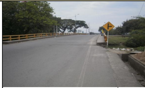
NO EXISTE PLACA DE IDENTIFICACIÓN
