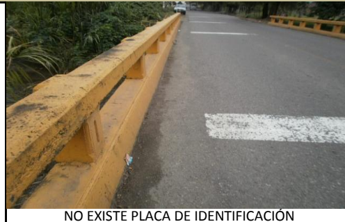
NO EXISTE PLACA DE IDENTIFICACIÓN
