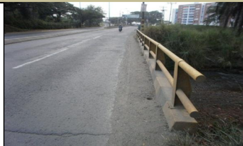
NO EXISTE PLACA DE IDENTIFICACIÓN
