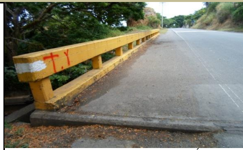
NO EXISTE PLACA DE IDENTIFICACIÓN
