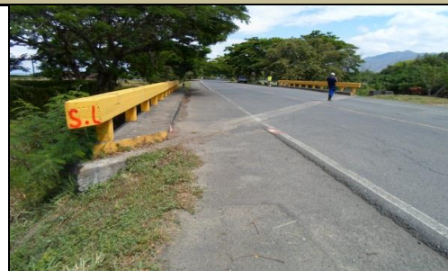
NO EXISTE PLACA DE IDENTIFICACIÓN
