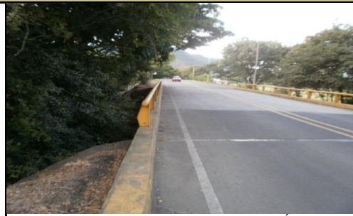
NO EXISTE PLACA DE IDENTIFICACIÓN
