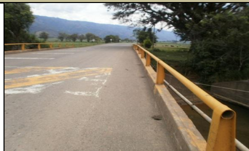
NO EXISTE PLACA DE IDENTIFICACIÓN.
