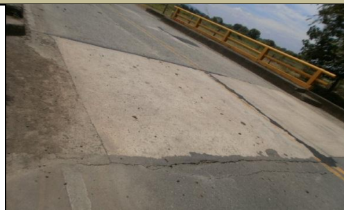
NO EXISTE PLACA DE IDENTIFICACIÓN
