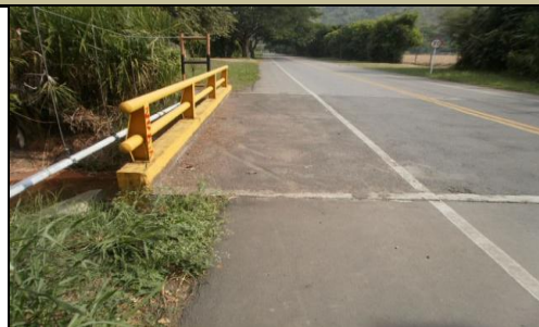
NO EXISTE PLACA DE IDENTIFICACIÓN
