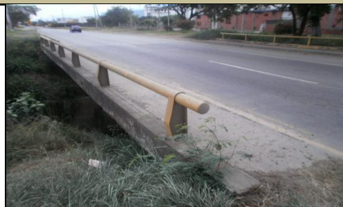
NO EXISTE PLACA DE IDENTIFICACIÓN
