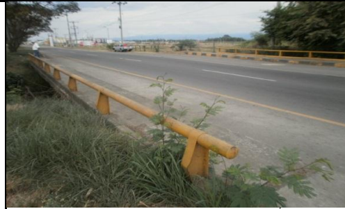
NO EXISTE PLACA DE IDENTIFICACIÓN
