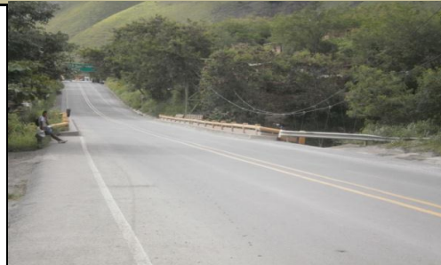
NO EXISTE PLACA DE IDENTIFICACIÓN
