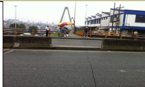
FOTO 2: PLACA DE IDENTIFICACION-NO EXSITE
