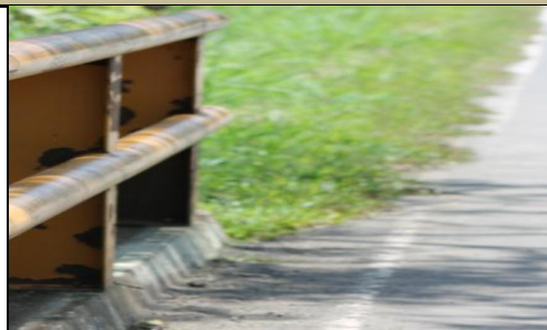
FOTO 2: PLACA IDENTIFICACIÓN PUENTE-NO EXISTE
