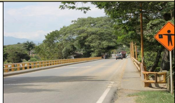
FOTO 2: PLACA IDENTIFICACIÓN PUENTE-NO EXISTE
