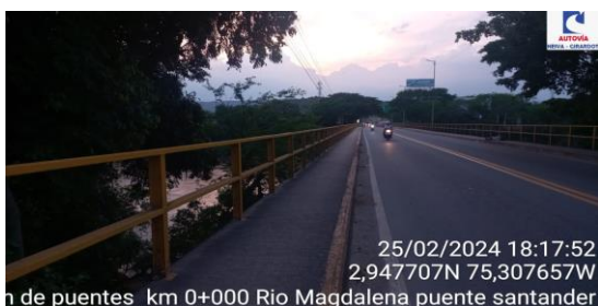
FOTO N° 4 BARANDAS METALICAS PUENTE SANTANDER K0+000 UF1,5
