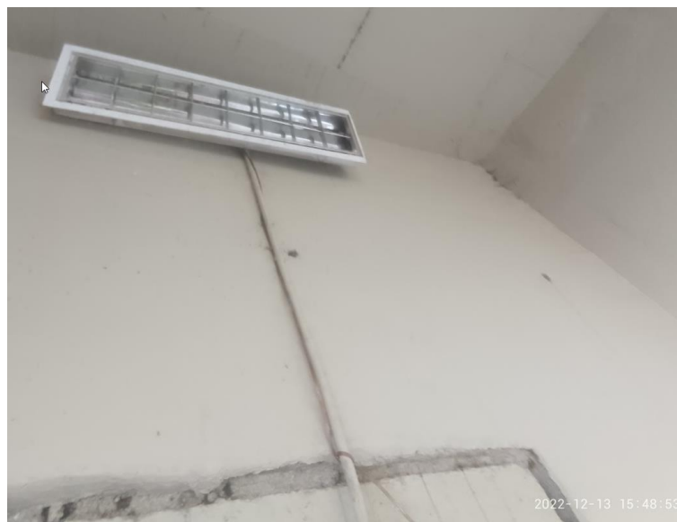
Fotografía 10. Iluminación del Puente Paso Inferior Peatonal Estribo 1 Fuente: Sinerging S.A.S.
