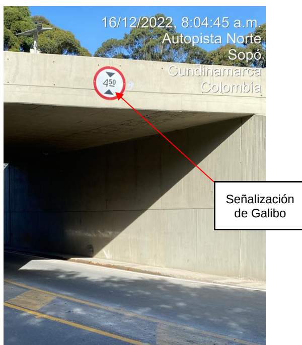
Fotografía 10. Señalización Del Box Fuente: Sinerging S.A.S.
