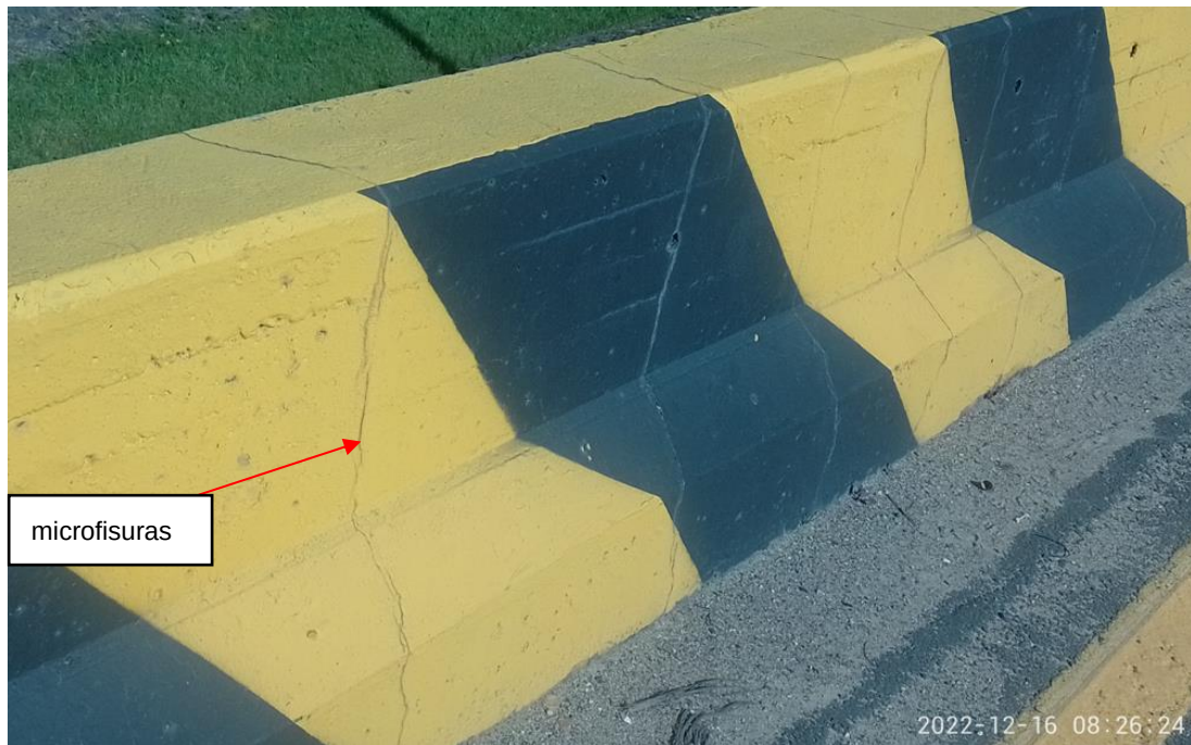
Fotografía 7. Barreras De Concreto vista microfisuras Fuente: Sinerging S.A.S.
