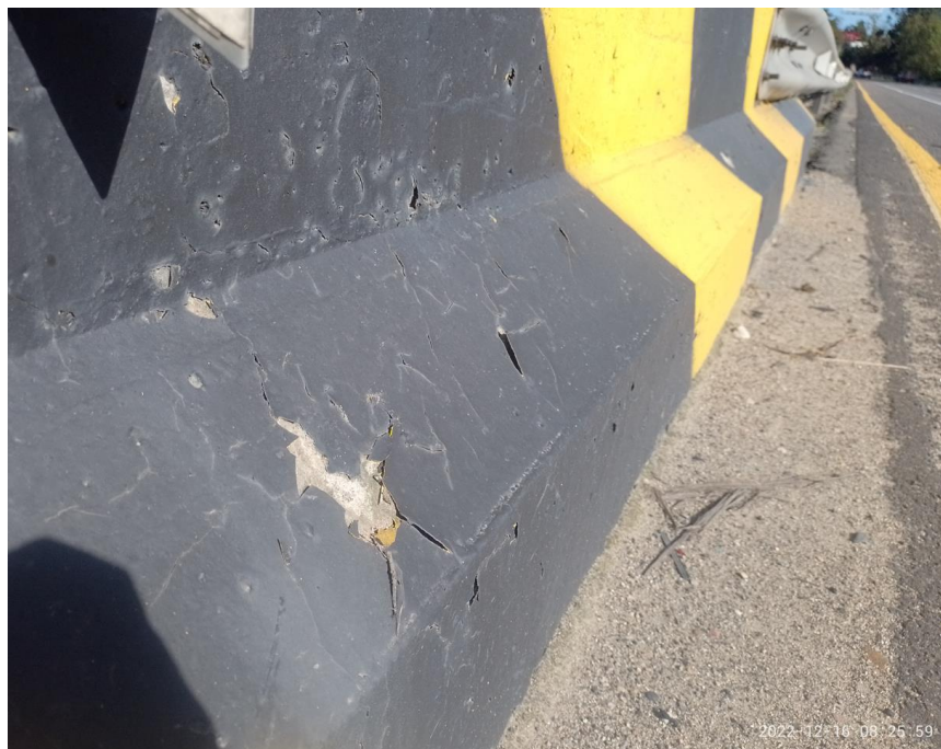
Fotografía 6. Barreras De Concreto desprendimiento de pintura Fuente: Sinerging S.A.S.
