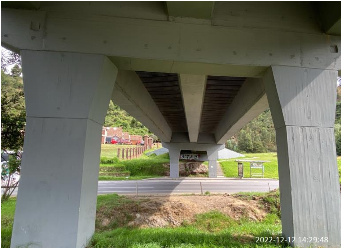
Fotografía 19. Vista general de las pilas Fuente: Sinerging S.A.S.
