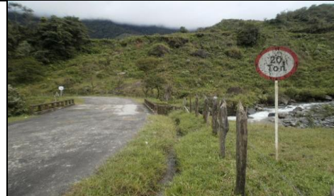
FOTO 2: PLACA IDENTIFICACIÓN PUENTE - NO EXISTE
