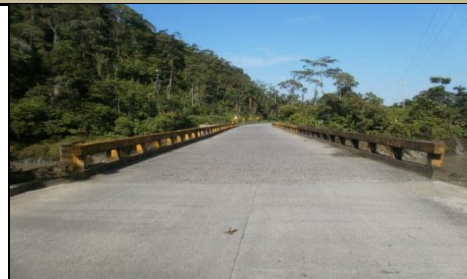
FOTO 2: PLACA IDENTIFICACIÓN PUENTE. NO EXISTE.
