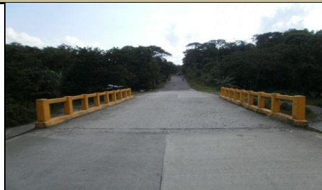
FOTO 2: PLACA IDENTIFICACIÓN PUENTE. NO EXISTE.
