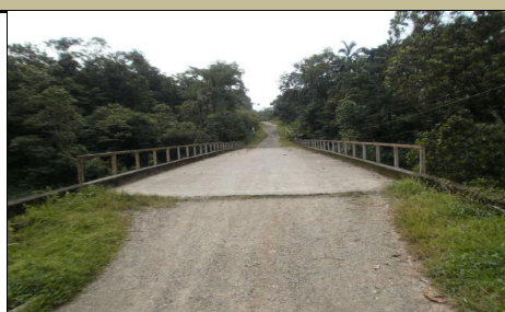
FOTO 2: PLACA IDENTIFICACIÓN PUENTE - NO EXISTE
