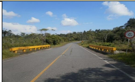
FOTO 2: PLACA IDENTIFICACIÓN PUENTE. NO EXISTE.
