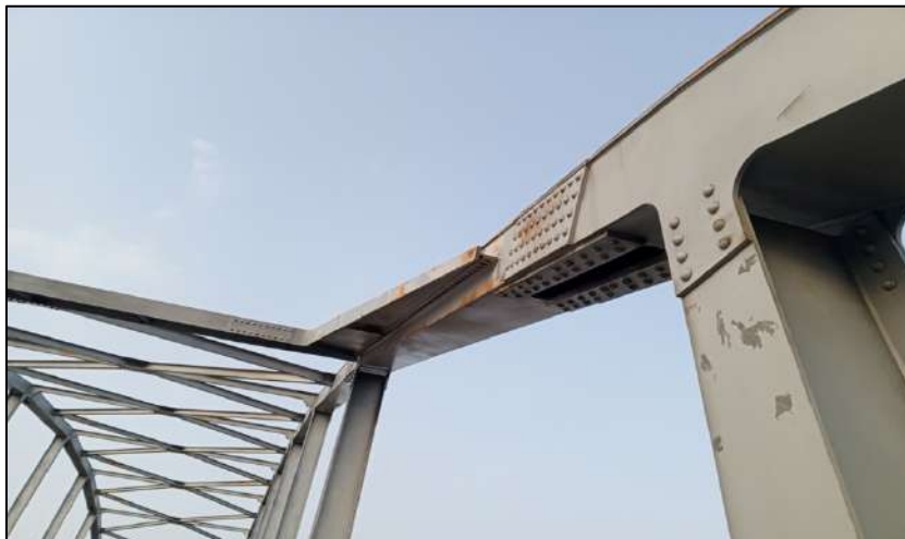
Ilustración 61 Pérdida de pintura y oxidación arco costado izquierdo
