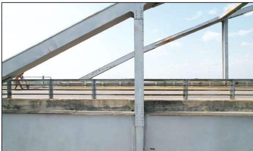
Ilustración 72 Pérdida de pintura y oxidación
