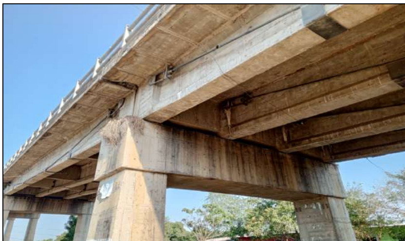
Ilustración 33 Degradación de concreto en aleros
