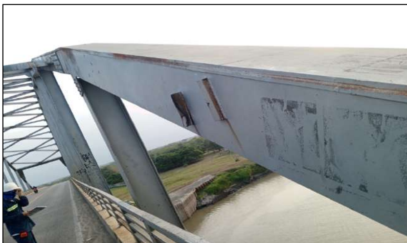
Ilustración 101 Oxidación en zona de soldaduras
