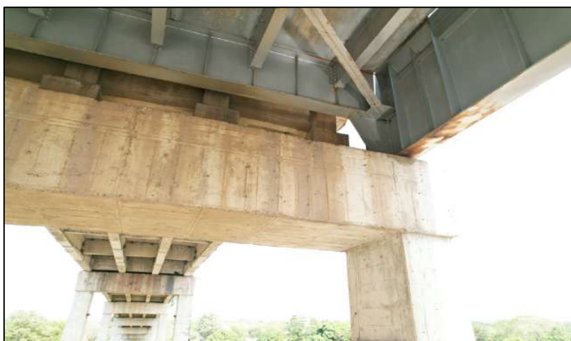
Ilustración 82 Pérdida de pintura y oxidación en ala inferior de vigas longitudinales
