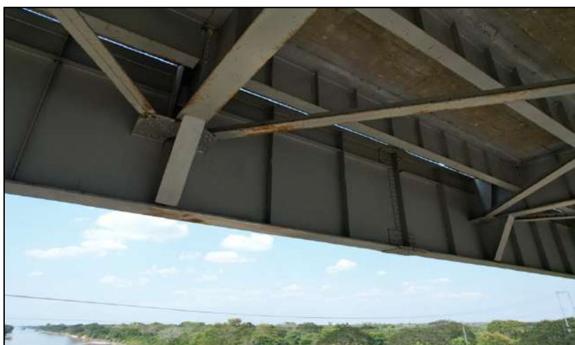
Ilustración 87 Pérdida de pintura y oxidación
