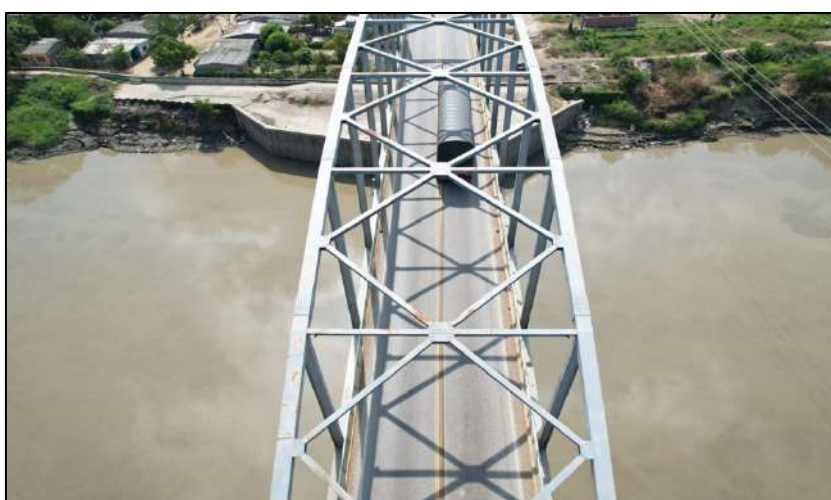
Ilustración 60 Oxidación cara superior arco derecho
