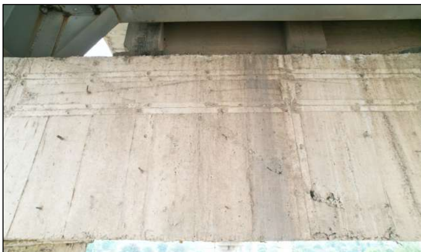
Ilustración 47 Hormigueros en viga cabezal pila 1
