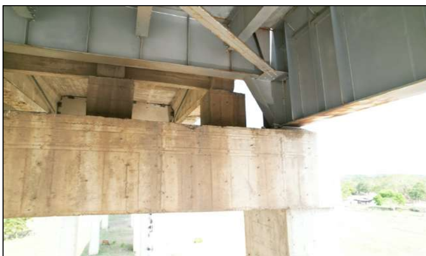
Ilustración 85 Pérdida de pintura y oxidación
