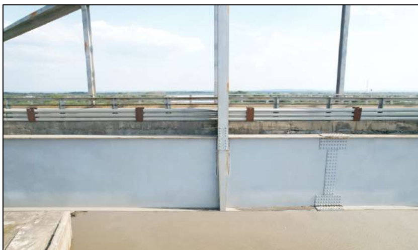
Ilustración 75 pérdida de pintura y oxidación
