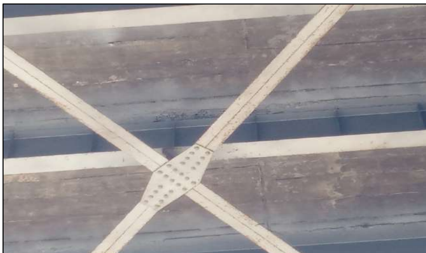
Ilustración 104 Hormigueros en losa
