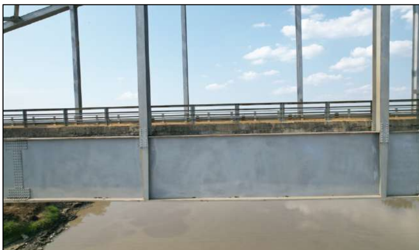
Ilustración 106 Pérdida de concreto en unión con bordillo
