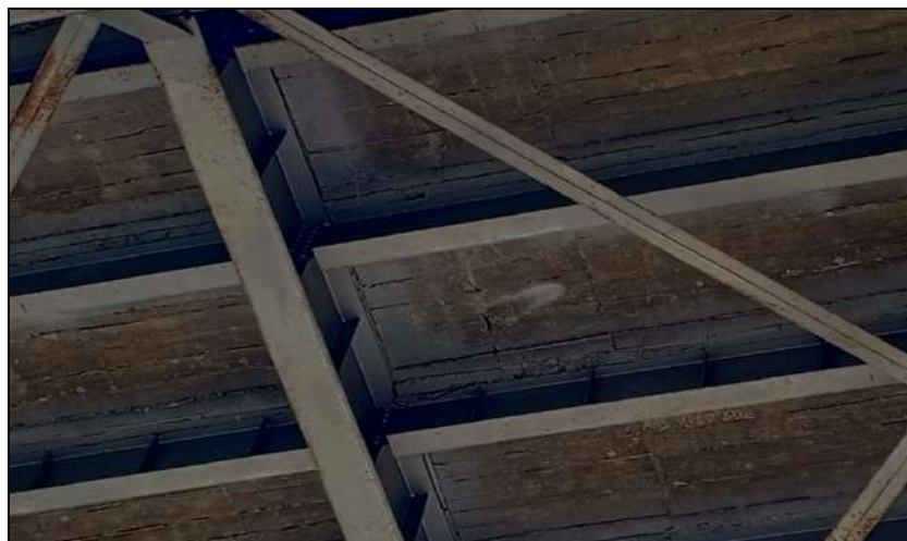
Ilustración 103 Eflorescencias en losa
