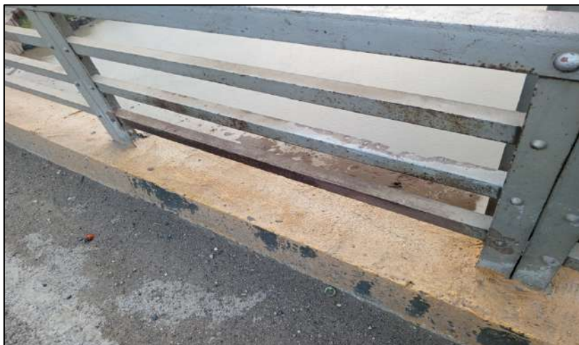
Ilustración 12 Pérdida de sección por corrosión
