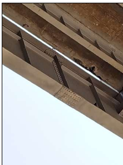
Ilustración 102 Degradación de concreto, humedades y eflorescencias
