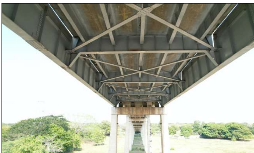
Ilustración 84 Pérdida de pintura y oxidación
