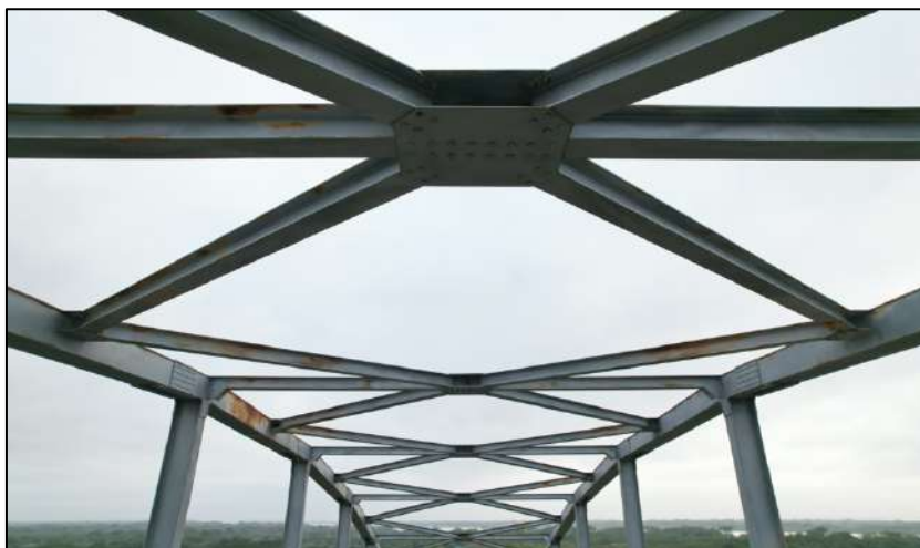
Ilustración 67 Pérdida de pintura y oxidación
