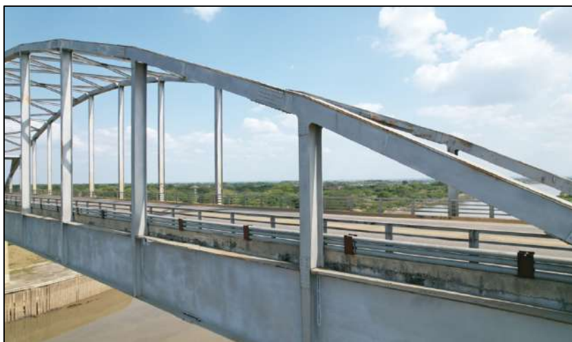
Ilustración 63 Pérdida de pintura y oxidación en soldadura arco costado izquierdo
