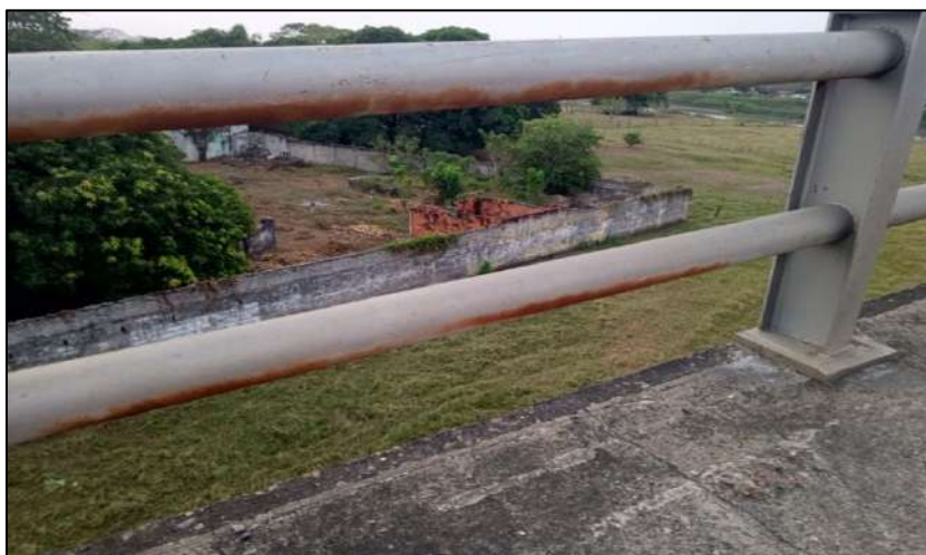
Ilustración 26 Pérdida de pintura y oxidación en baranda
