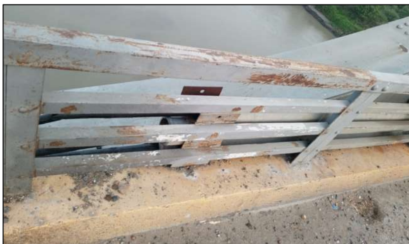
Ilustración 15 Oxidación en baranda
