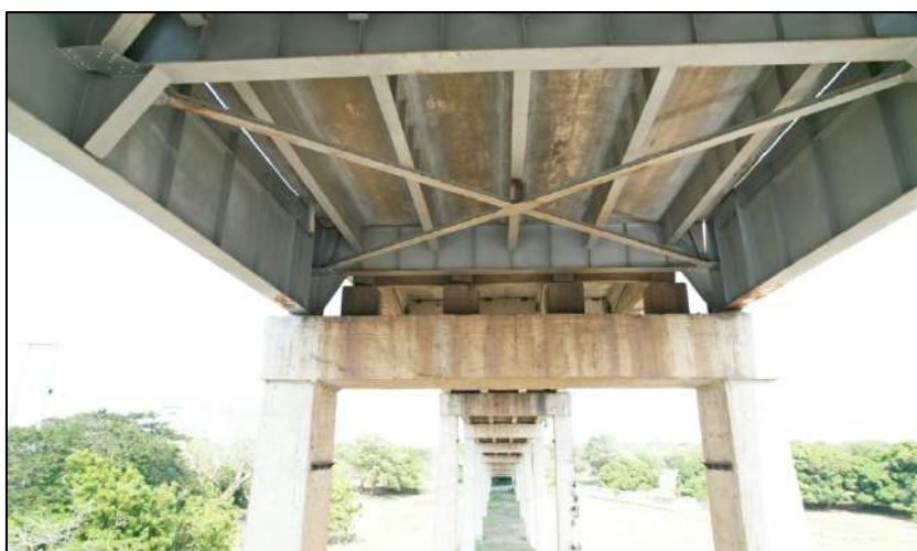
Ilustración 90 Pérdida de pintura y oxidación
