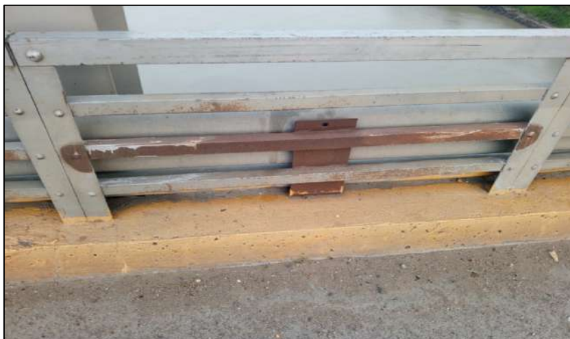
Ilustración 14 Ausencia de protección en elemento sustituido
