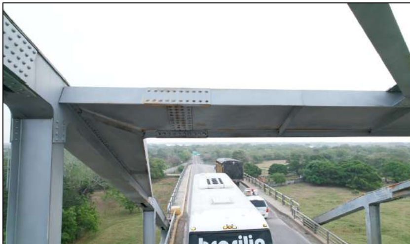
Ilustración 69 Pérdida de pintura y oxidación
