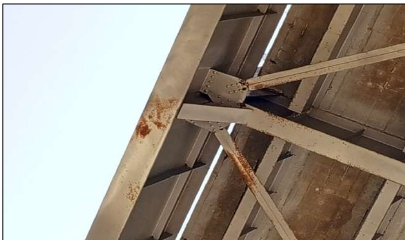
Ilustración 86 Pérdida de pintura y oxidación
