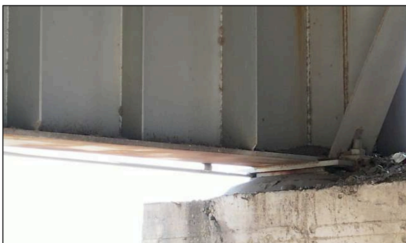
Ilustración 83 Pérdida de pintura y oxidación en ala inferior de vigas longitudinales
