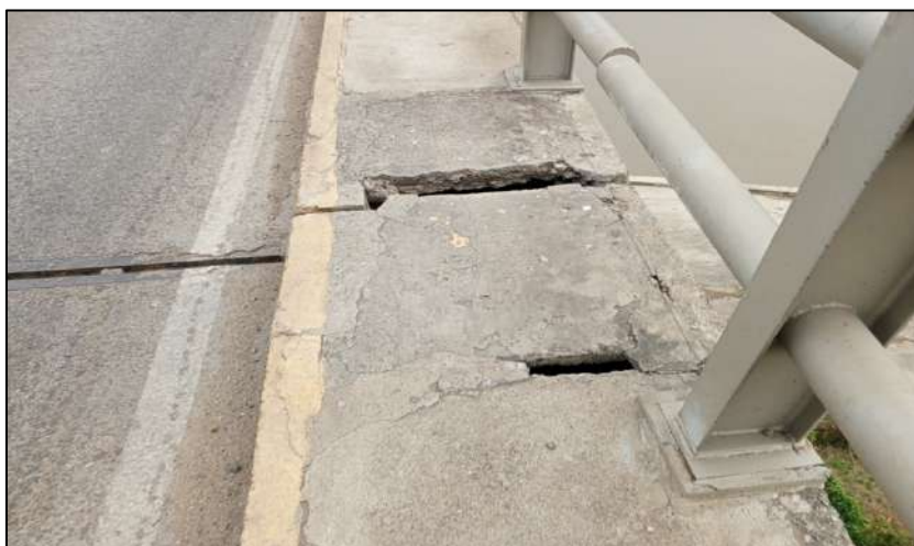
Ilustración 25 Pérdida de sección en andén
