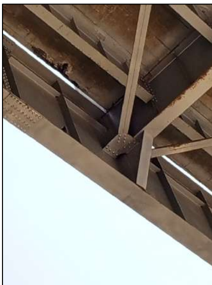
Ilustración 19 Longitud insuficiente de drenajes
