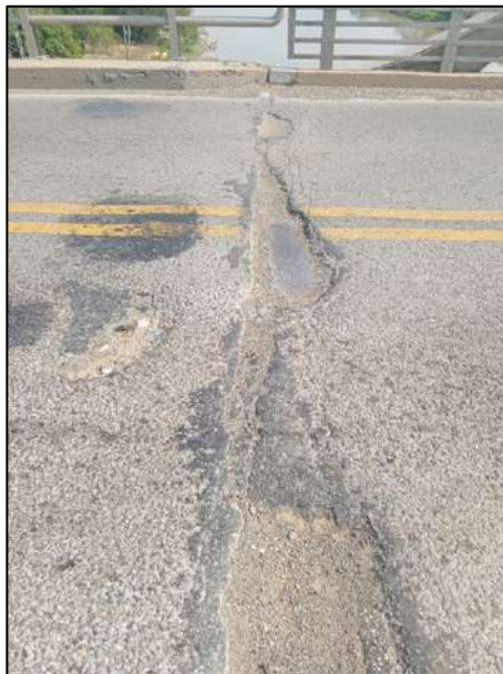
Ilustración 7 Degradación superficial y pérdida de material
