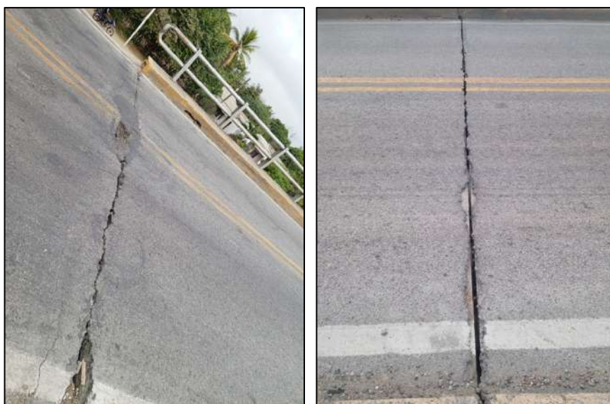
Ilustración 23 Juntas de dilatación en accesos
