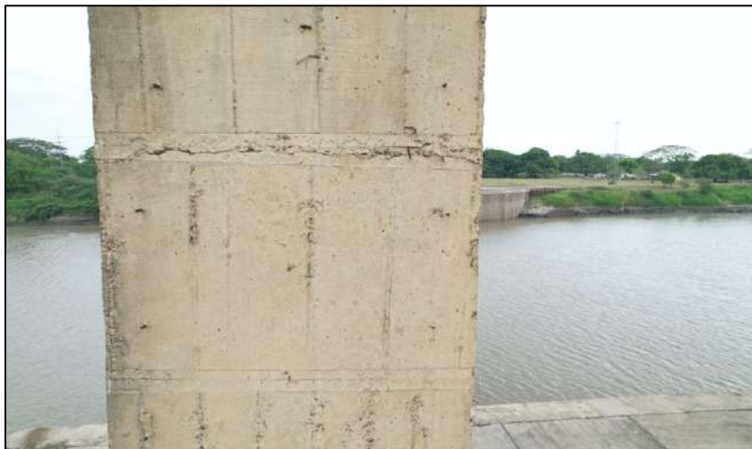
Ilustración 46 Fisuración por junta fría
