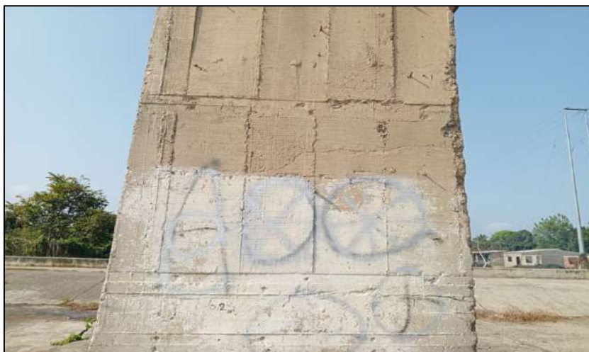
Ilustración 37 Fisuración y juntas frías en fuste
