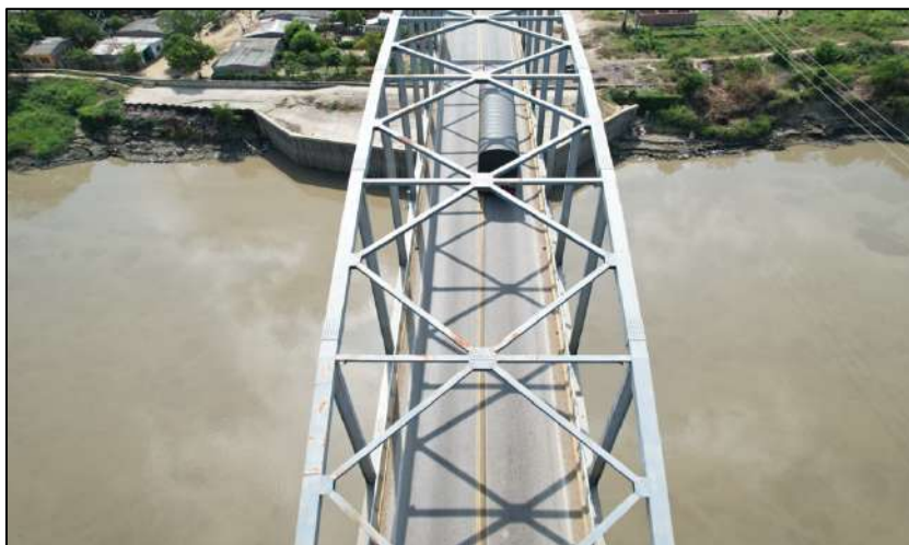
Ilustración 71 Pérdida de pintura y oxidación zona superior
