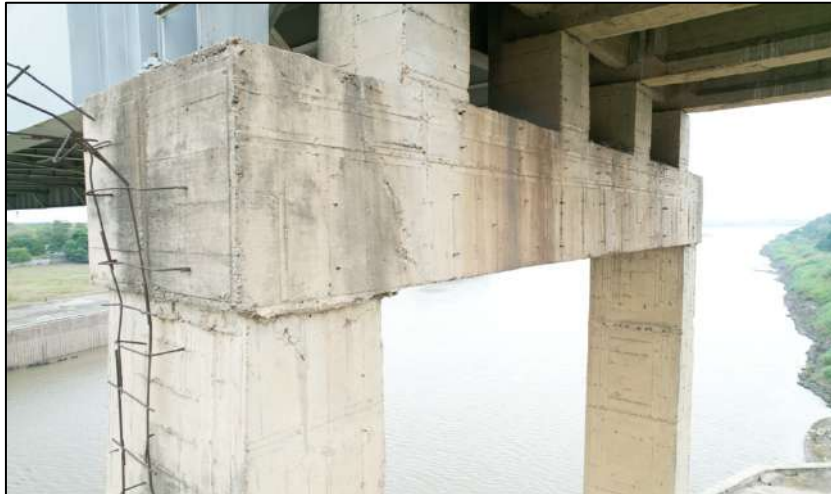
Ilustración 45 Humedades y biocapas en viga cabezal
