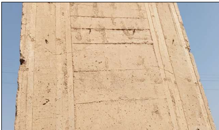
Ilustración 38 Fisuración y juntas frías en fuste
