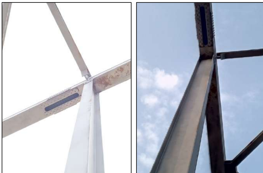
Ilustración 56 Pérdida de pintura y oxidación en cara inferior arco costado derecho
