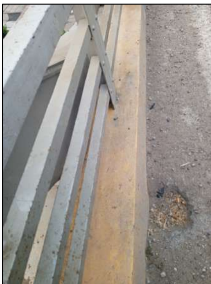
Ilustración 18 Obstrucción de drenajes
