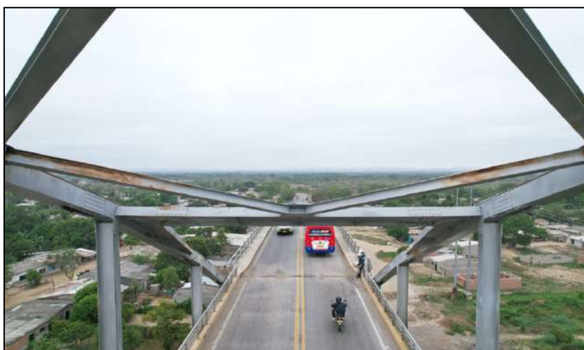
Ilustración 68 Pérdida de pintura y oxidación
