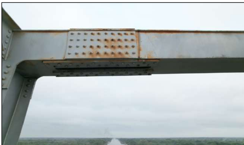
Ilustración 94 Pérdida de pintura y oxidación
