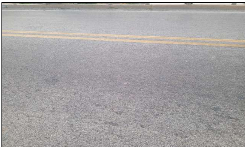
Ilustración 6 Fisuración de pavimento
