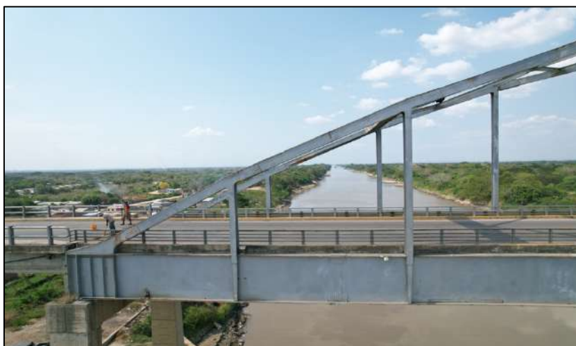
Ilustración 57 Pérdida de pintura y oxidación cara exterior arco costado derecho
