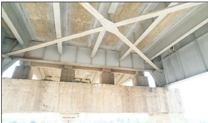
Ilustración 81 Pérdida de pintura y oxidación en vigas longitudinales
