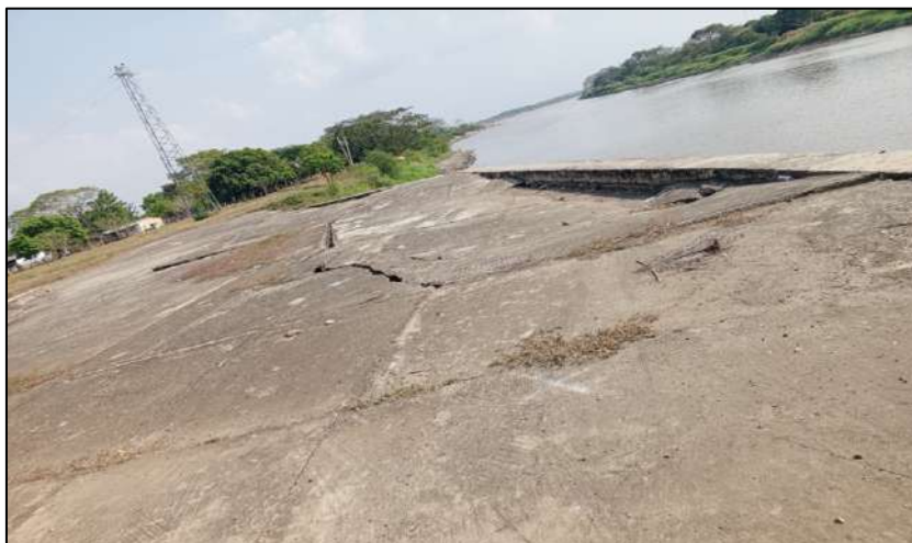
Ilustración 109 Rotura y asentamiento losa sentido Barranquilla
