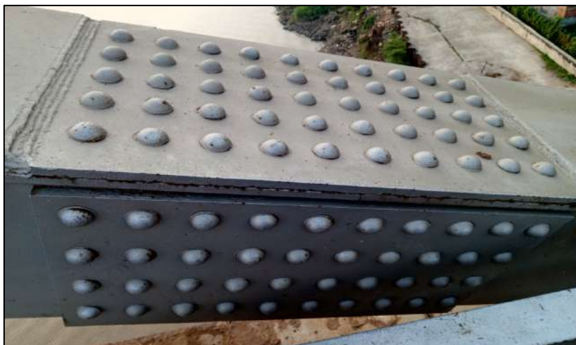
Ilustración 91 Pérdida de pintura y oxidación
