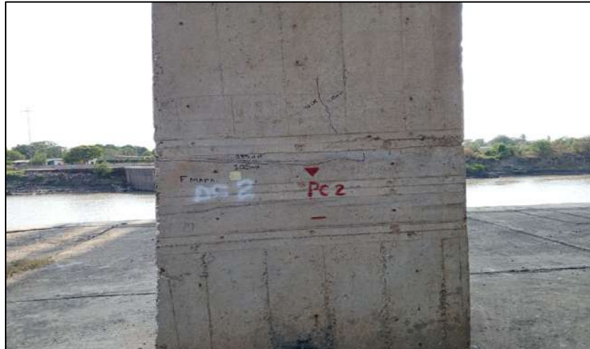
Ilustración 42 Fisuración en fuste de pila 2
