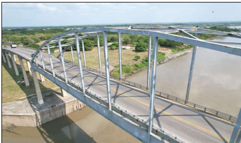
Ilustración 64 Pérdida de pintura y oxidación arco costado izquierdo
