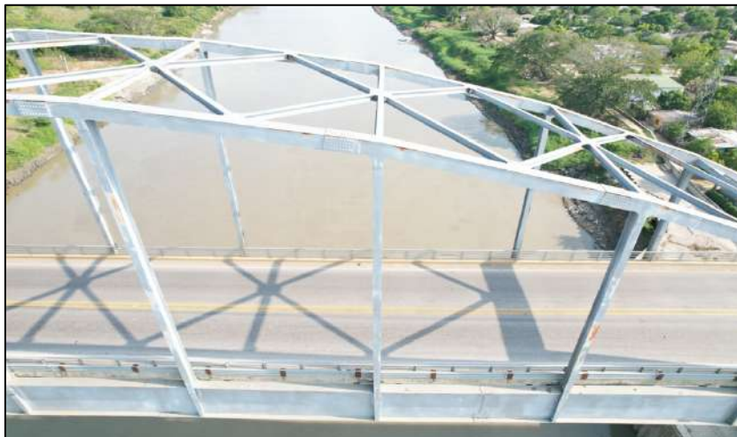
Ilustración 74 pérdida de pintura y oxidación
