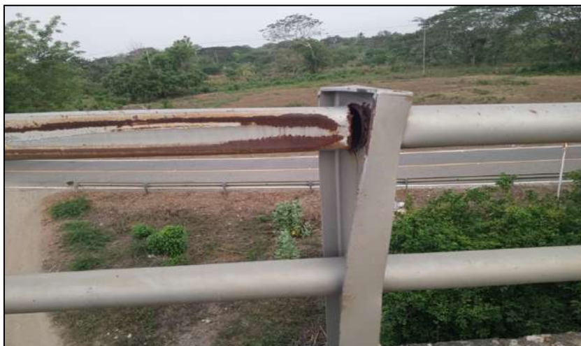
Ilustración 27 Impacto y rotura de sección en baranda
