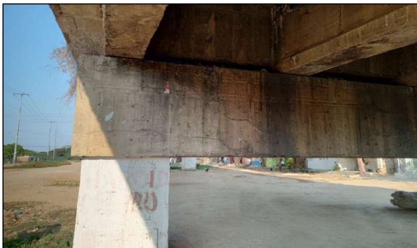
Ilustración 30 Fisuración en viga cabezal
