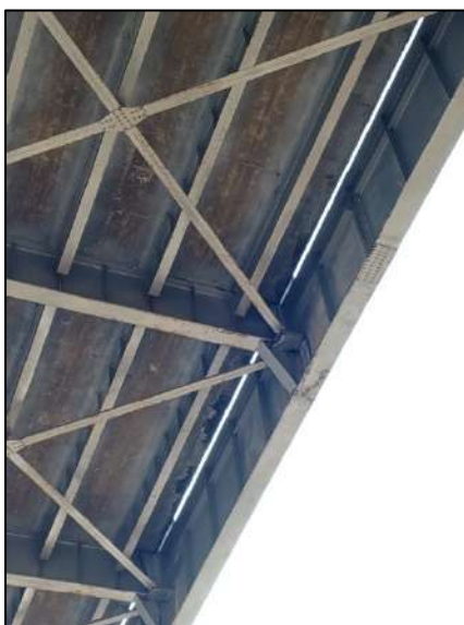
Ilustración 105 Humedades, biocapas, eflorescencias, pérdida de recubrimiento
