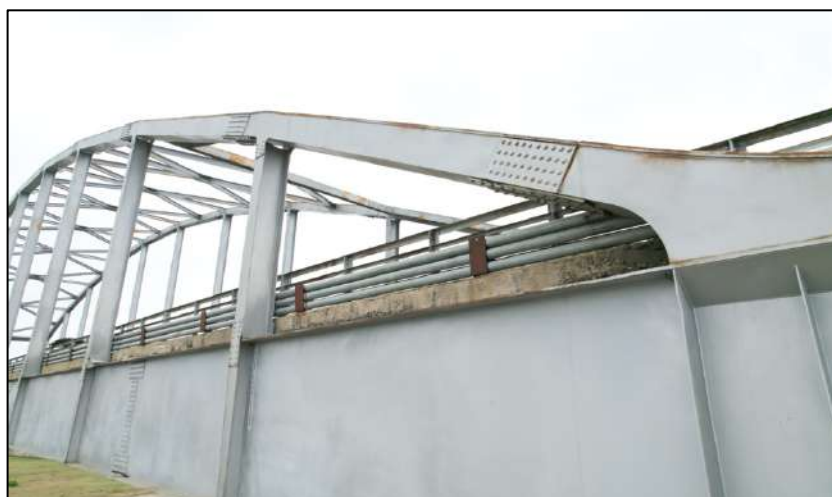
Ilustración 65 Pérdida de pintura y oxidación arco costado izquierdo
