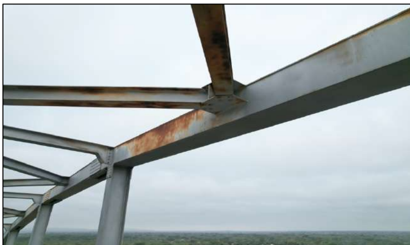
Ilustración 70 Pérdida de pintura y oxidación
