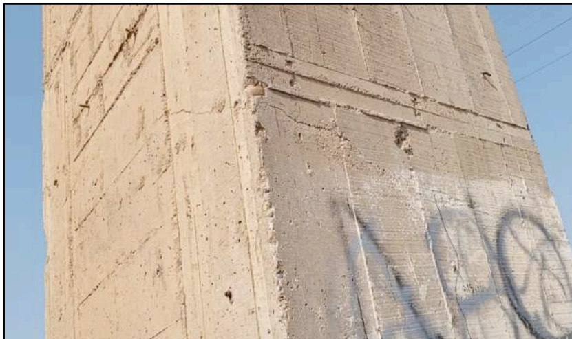
Ilustración 39 Fisuración con continuidad en caras
