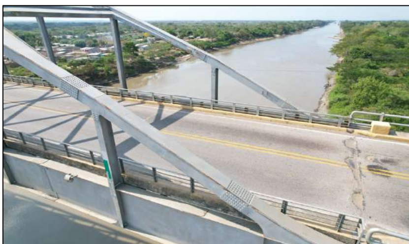
Ilustración 59 Oxidación en soldadura cara superior arco costado derecho
