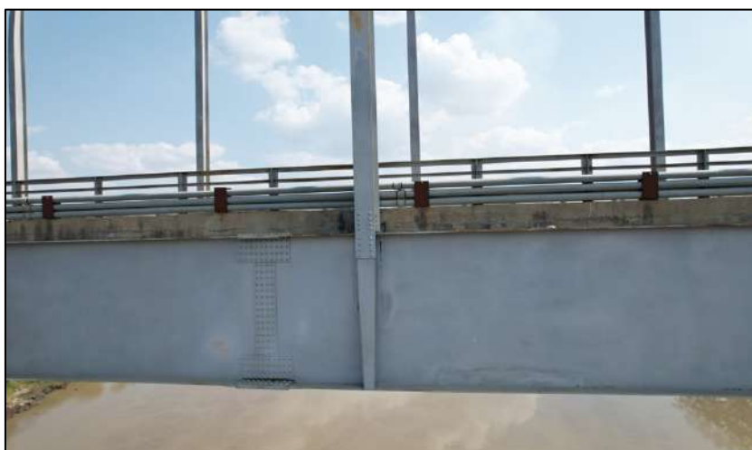
Ilustración 79 Pérdida de pintura y oxidación
