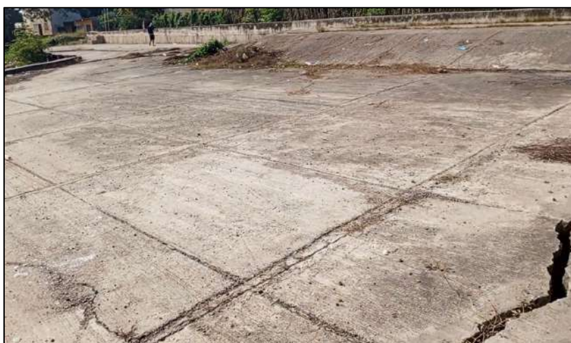
Ilustración 108 Rotura y asentamiento losa sentido Calamar
