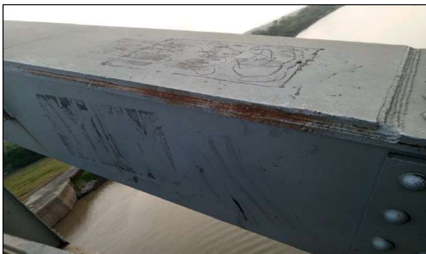
Ilustración 54 Oxidación en zona de soldadura arco costado derecho
