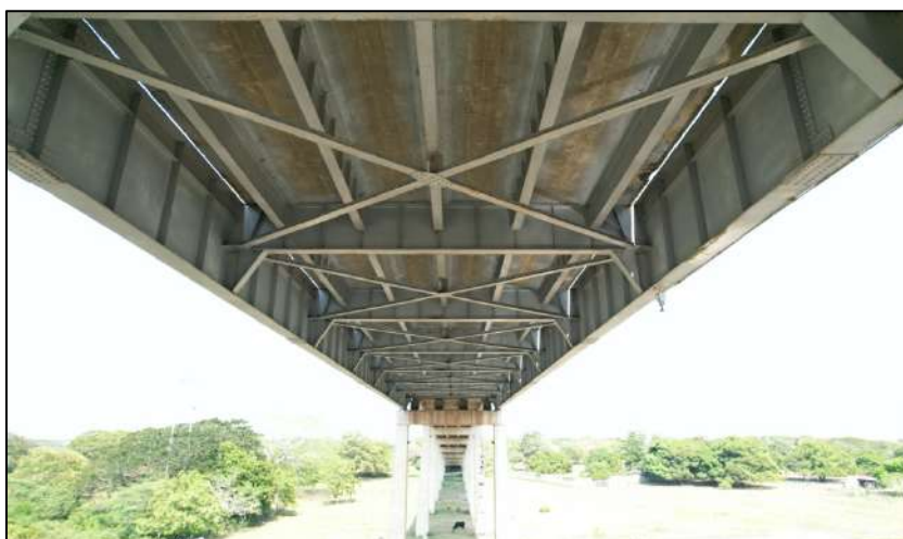
Ilustración 89 Pérdida de pintura y oxidación
