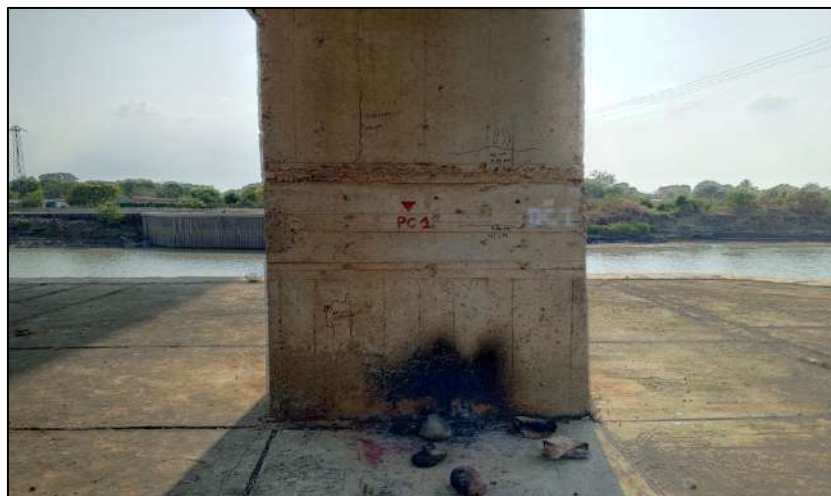
Ilustración 44 Fisuración y manchas de hollín en pila 2
