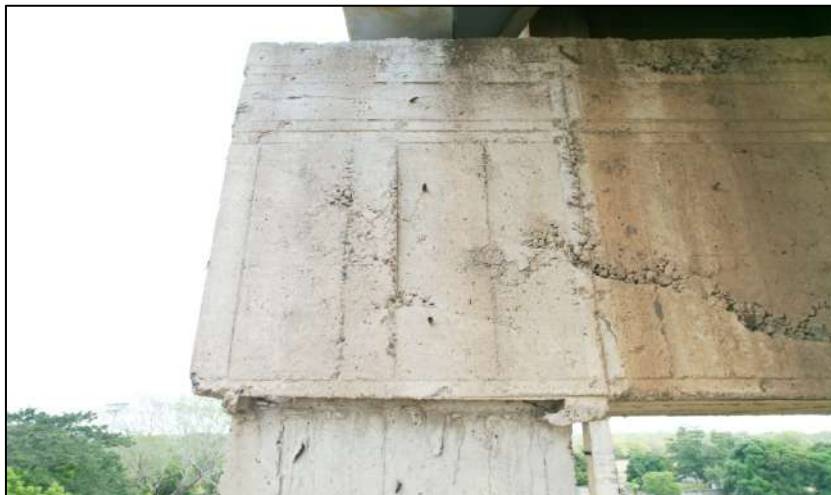
Ilustración 48 Hormigueros en viga cabezal pila 2
