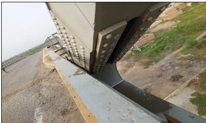
Ilustración 62 Pérdida de pintura y oxidación arco costado izquierdo
