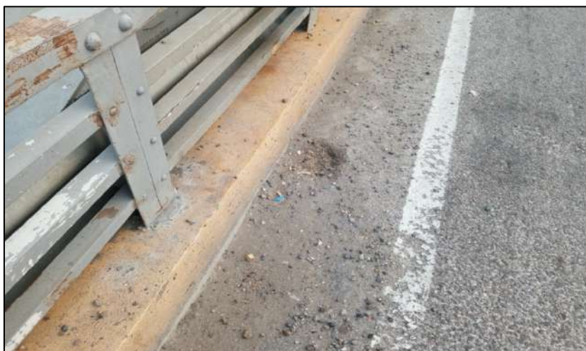
Ilustración 11 Fisuración en bordillo
