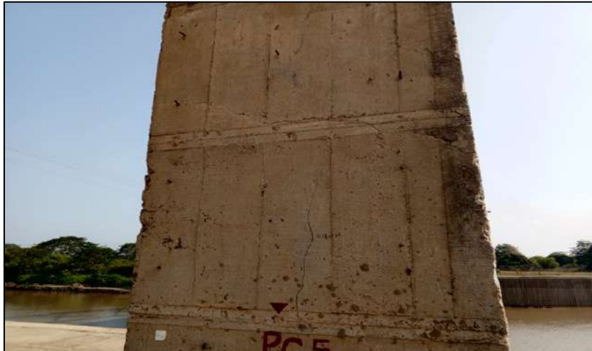
Ilustración 36 Fisuración en fuste
