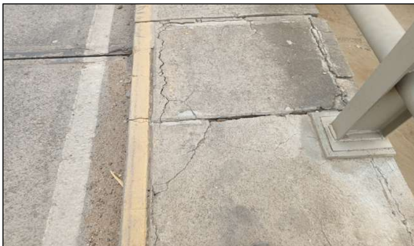
Ilustración 24 Agrietamiento de placa en andén
