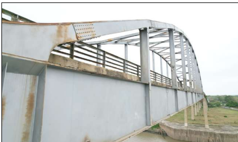
Ilustración 58 Pérdida de pintura y oxidación cara exterior arco costado derecho
