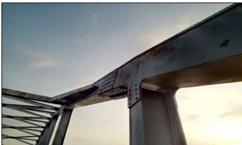
Ilustración 53 Pérdida de pintura y oxidación en arco derecho
