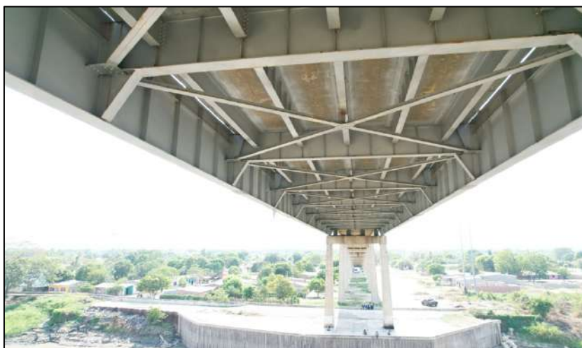
Ilustración 80 Pérdida de pintura y oxidación en vigas longitudinales
