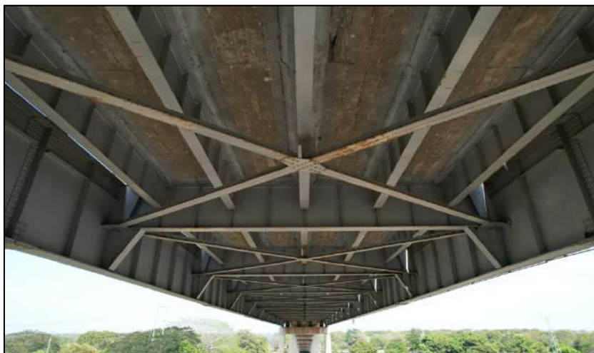
Ilustración 88 Pérdida de pintura y oxidación
