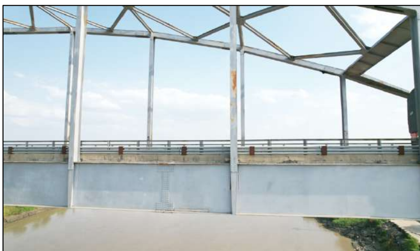
Ilustración 73 pérdida de pintura y oxidación
