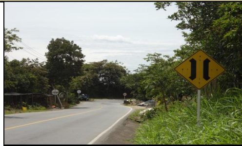
FOTO 2: PLACA IDENTIFICACIÓN PUENTE-NO EXISTE
