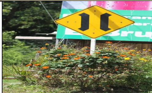
FOTO 2: PLACA IDENTIFICACIÓN PUENTE - NO EXISTE
