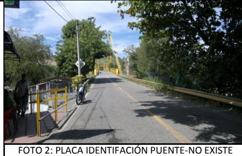
FOTO 2: PLACA IDENTIFICACIÓN PUENTE-NO EXISTE
