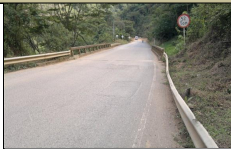
FOTO 2: PLACA IDENTIFICACIÓN PUENTE-NO EXISTE
