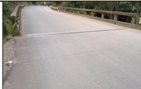
FOTO 2: PLACA IDENTIFICACIÓN PUENTE-NO EXISTE
