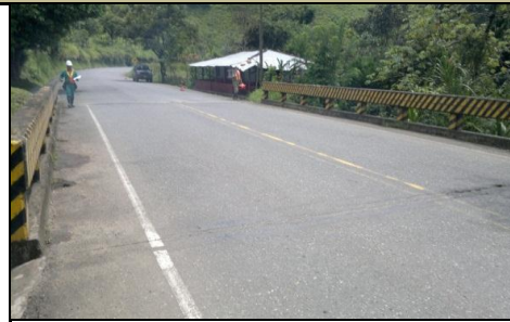
FOTO 2: PLACA IDENTIFICACIÓN PUENTE (NO EXISTE)
