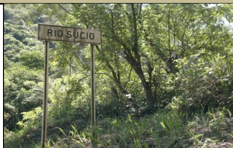
FOTO 2: PLACA IDENTIFICACIÓN PUENTE- NO EXISTE
