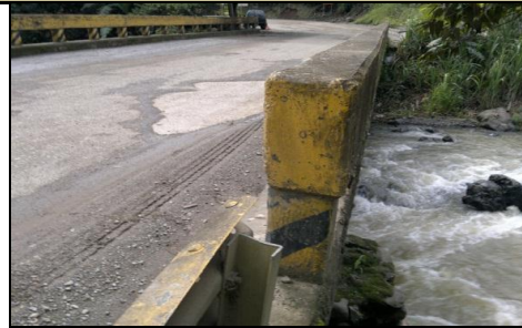
FOTO 2: PLACA IDENTIFICACIÓN PUENTE- NO EXISTE
