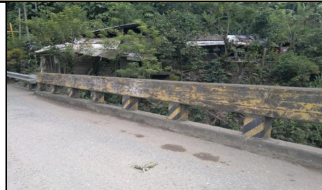
FOTO 2: PLACA IDENTIFICACIÓN PUENTE - NO EXISTE
