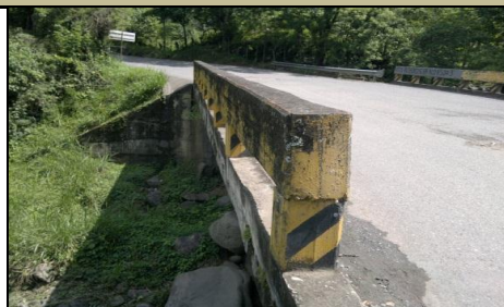
FOTO 2: PLACA IDENTIFICACIÓN PUENTE - NO EXISTE
