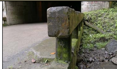
FOTO 2: PLACA IDENTIFICACIÓN PUENTE - NO EXISTE
